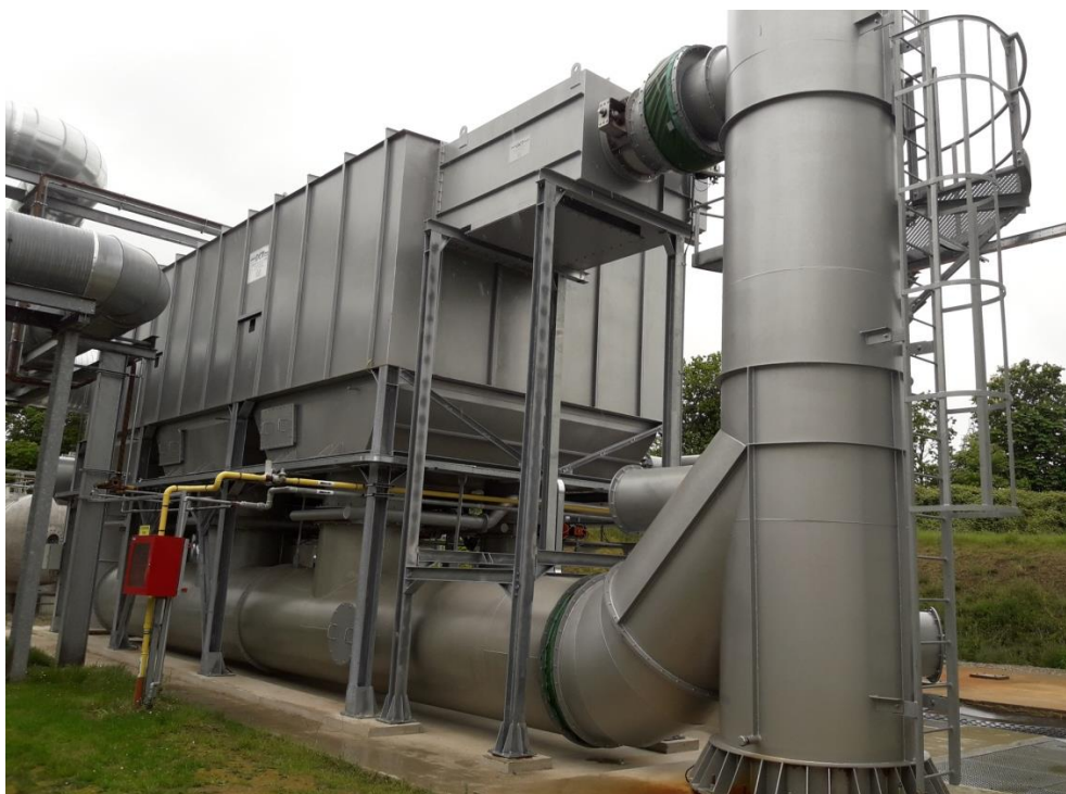
Figure 9 : Aperçu du nouvel incinérateur sur le site de EMSUR France SPO
